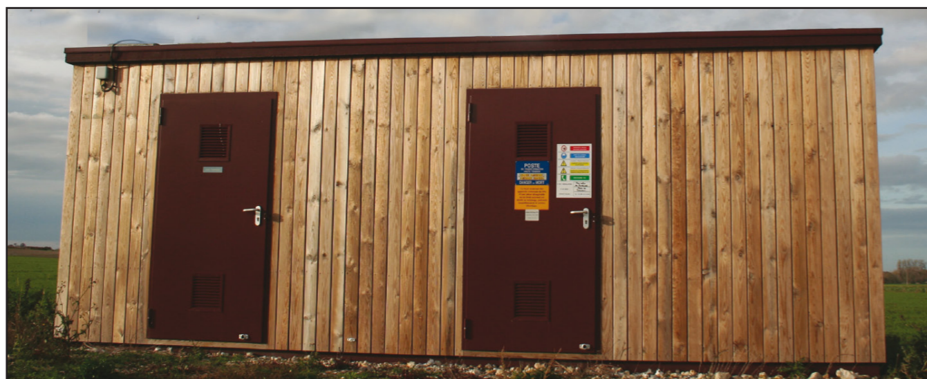
Figure 129 : Poste de livraison type
